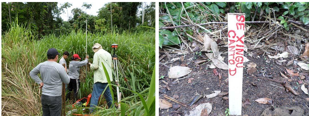
Figura 12 - Equipe de topografia e visita ao canto "D" da futura área a ser ampliada da subestação.
