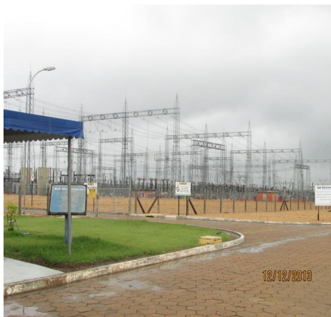
Figura 3 – Vista da SE Miracema - TO
