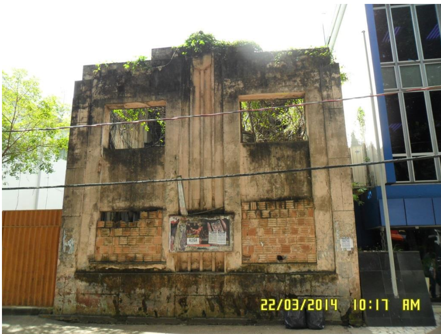
Figura 6.4-225 – Imóvel em ruínas, este situado no entorno da Praça Duque de Caxias na Marabá Pioneira (coordenadas: S 05° 21' 00.3" W 049° 08' 13.2").
