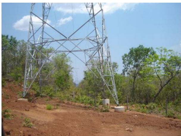
Figura 6.3-82 - Vista da abertura da faixa de vegetação do cerrado para lançamento dos cabos aéreos.
