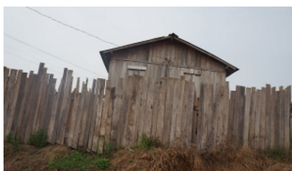
Foto 4.4.8.4-152: Residência de madeira em estado ruim no Bairro Paraíso 01 (9508018.93 m S 711112.79 m E), distância de 4,4 km a oeste do traçado da futura LT.
