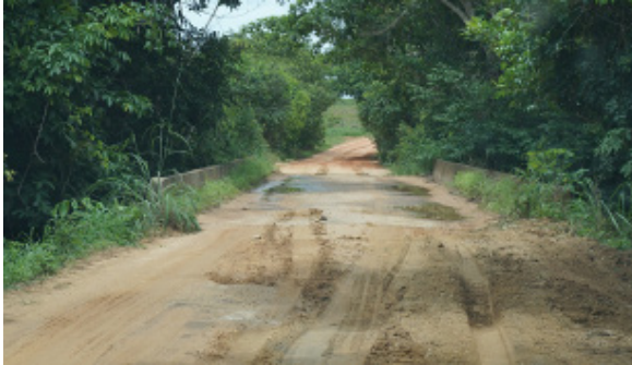
Foto 4.4.8.4-92: Ponte de concreto em estrada sem pavimentação, com condições razoáveis de trafegabilidade, na estrada vicinal (9228466.78 m S 750407.66 m E), distante 2,9 km a oeste do traçado da futura LT
