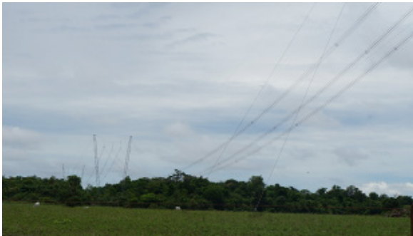
Foto 4.4.8.4-274: Cruzamento do traçado da futura LT com estrada vicinal, a jusante (9222437.23 m S 753707.70 m E) paralelo às LTs instaladas. Uso do solo: pasto e mata secundária
