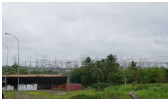
Foto 4.4.8.4-4: Vista da SE Tucuuruí (649118.23 m E 9576172.14 m S)
