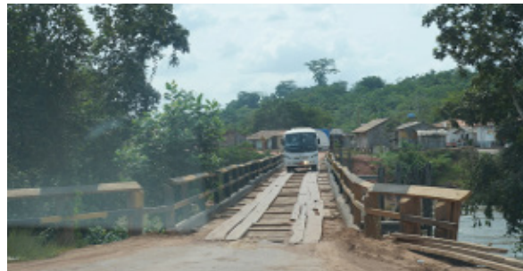
Foto 4.4.8.4-10: Desvio e ponte de madeira em péssimas condições de tráfego na Rodovia PA - 263 (9582677.48 m S 678492.00 m E), distante 800m ao sul do traçado da futura LT
