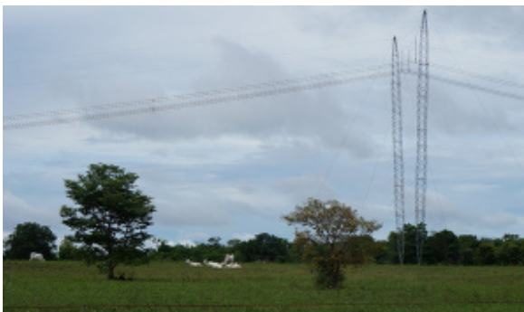
Foto 4.4.8.4-96: Vista de bovinos em LTs já instaladas (9222145.82 m S 754085.85 m E), distante 250m a leste do traçado da futura LT. Uso do Solo: Pasto e mata secundária
