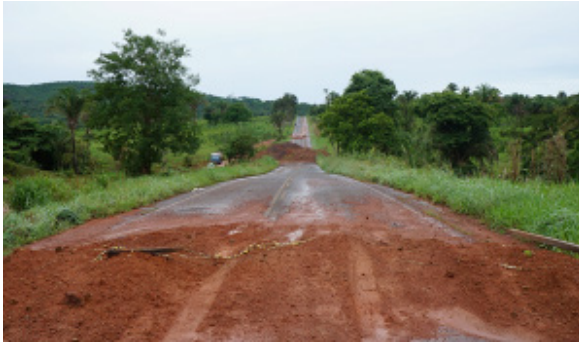
Foto 4.4.8.4-105: Desvio na Rodovia TO-222 (9202235.49 m S 780349.33 m E), distante 20km a leste do traçado da futura LT. Uso do Solo: Pasto e mata secundária
