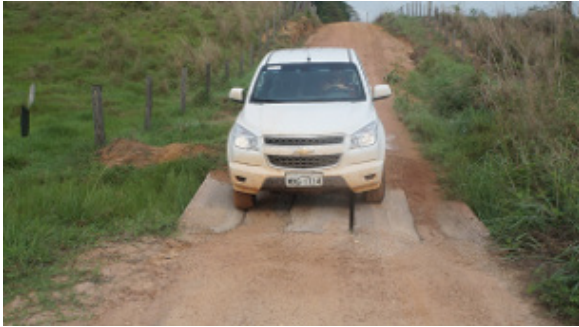
Foto 4.4.8.4-38: Ponte de madeira em péssimo estado (9502576.55 m S 712786.77 m E), distante 70m a oeste do traçado da futura LT. Uso do Solo: Pasto em ambos os lados da vicinal
