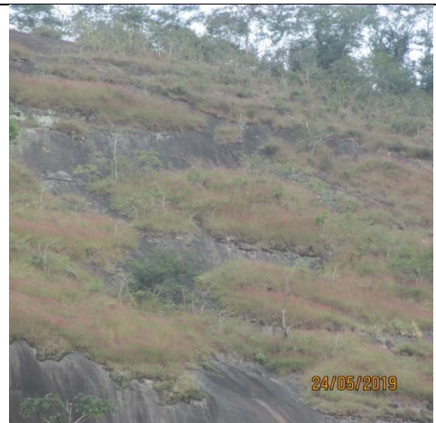
Foto 06: Parcela FL, em área de afloramento rochoso na LT Terminal Rio - Lagos, em Vassouras/RJ.
