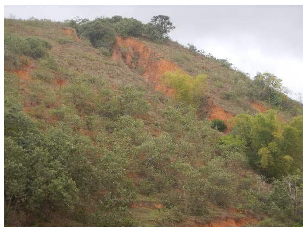
Foto 013: Vista geral da área com processos erosivos.
