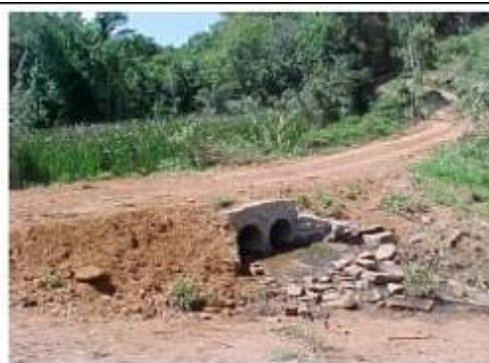
Foto 10-4 – Exemplo de dispositivo de drenagem (manilha) em travessia de córrego.
