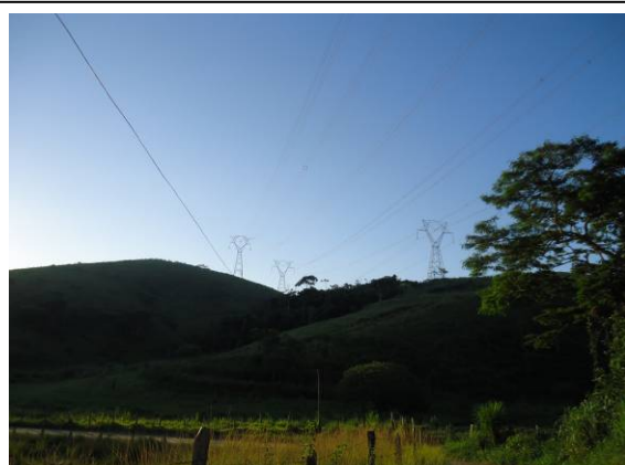
Foto II.4.4.5-58 – Vista do paralelismo das LTs existentes – município de Pirai (RJ).
