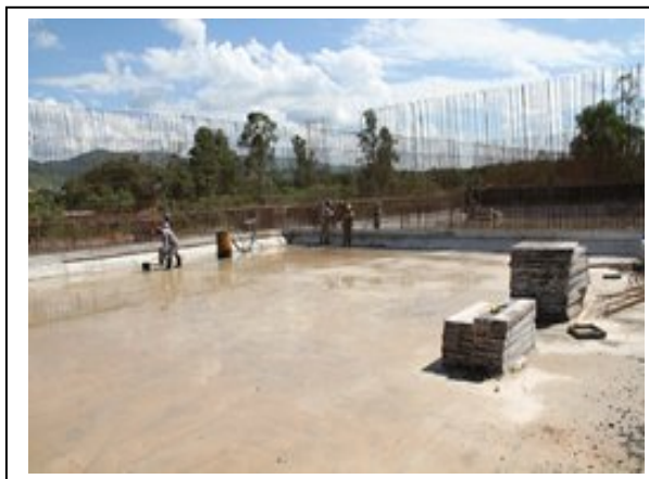
Foto II.4.4.2-14 – Construção da Estação de Tratamento de Esgoto – município de Aparecida (SP). Fonte: http://www.aparecida.sp.gov.br
