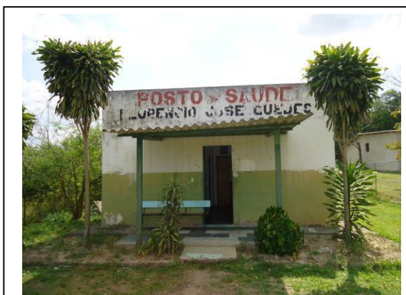
Foto II.4.4.2-5 – Posto de Saúde Florêncio José Guedes, na Gleba Santa Alice – município de Seropédica (RJ).
