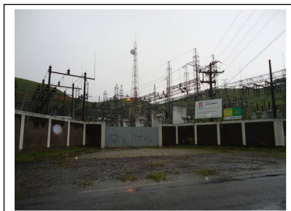
Foto II.4.4.5-14 – Subestação de Santa Cabeça, na Rodovia dos Tropeiros – município de Cachoeira Paulista (SP)
