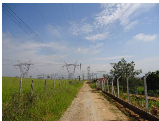
Foto II.4.4.5-3 – Vista da Subestação de Taubaté, a partir da localidade Sítio São José – município de Taubaté (SP)
