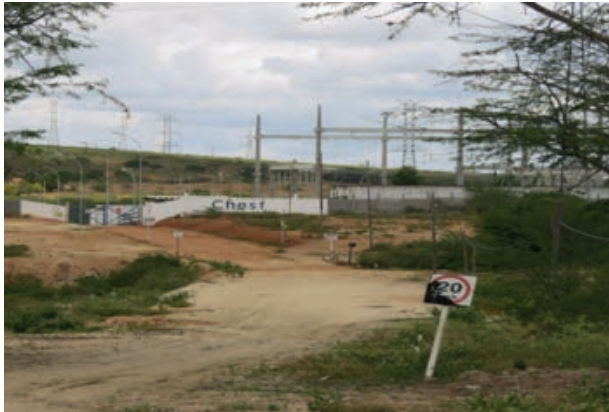
Foto 4.4-72: Infraestrutura da Subestação Poções II.
