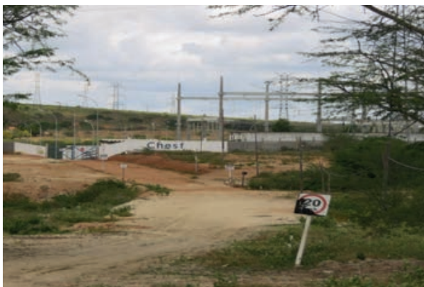
Foto 4.4-72: Infraestrutura da Subestação Poções II.
