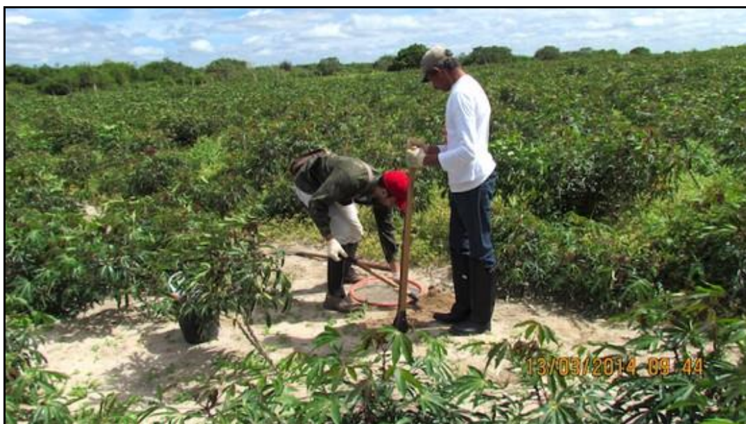
Figura 178. Procedimentos iniciais de identificação das áreas de intervenção em subsuperfície. Município de Ouricuri, em 13/03/2014, coordenada: 24S 329804/9112629.
