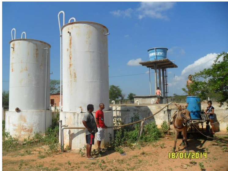
Figura 7.4-198 – Estação de Tratamento da água de Borda do Lago. Coordenadas (S08°55'10.3"/W038°10'24.3")
