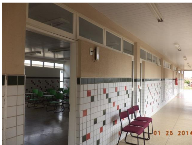
Figura 7.4-57 – Instituto Federal de Educação, Ciência e Tecnologia do Piauí (IFPI) /PI. (Coordenadas: S 08°21'44, 8" / W 042°15'16")
