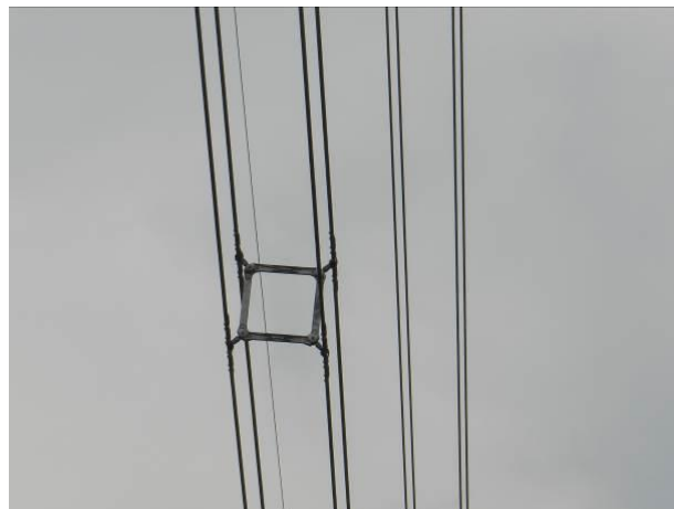
Figura 4.8-7 - Detalhe do espaçador entre os cabos.
