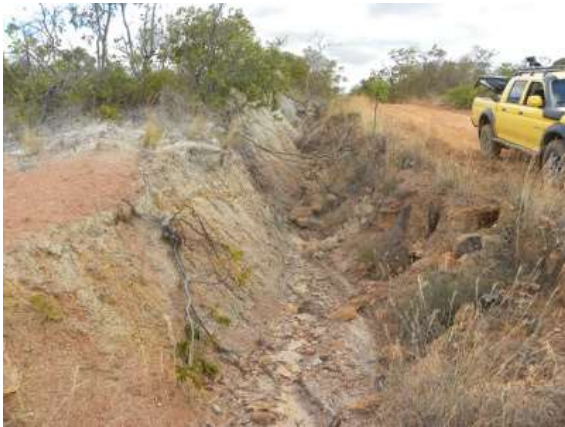
Foto 5.2-237: Evolução de erosão profunda nas margens da via de acesso local em função da concentração de águas pluviais. Coord. 23 K 449.860 m E, 8.153.747 m S.
