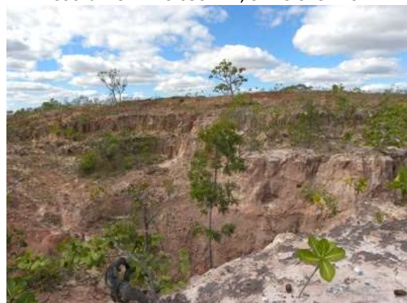
Foto 5.2-236: Encosta comprometida por erosão profunda, expondo o substrato local, ativada pela concentração de águas pluviais. Coord. 23 K 452.232 m E, 8.157.035 m S.
