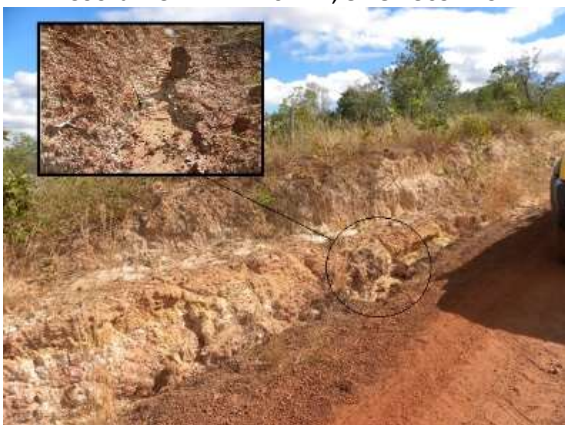
Foto 5.2-235: Evolução de erosão rasa na lateral de via de acesso comprometendo o fluxo local. Coord. 23 K 436.658 m E, 8.176.942 m S.
