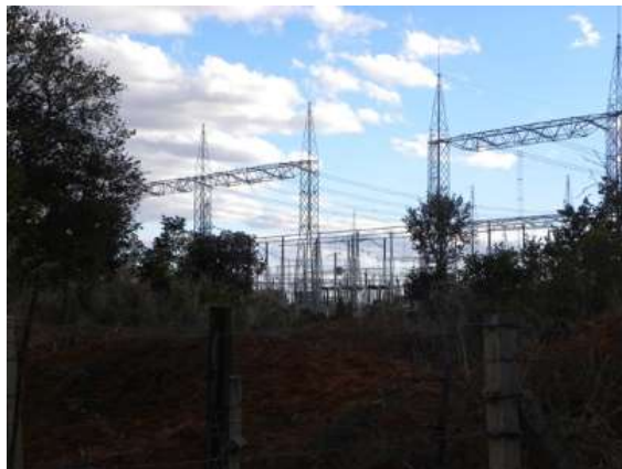
Foto 5.2-181: SE Pirapora 2, posicionada em terrenos associados a unidade “Superfície de Acumulação e Colinas Amplas”. Coord. 23 K 514.116 m E, 8.083.163 m S.
