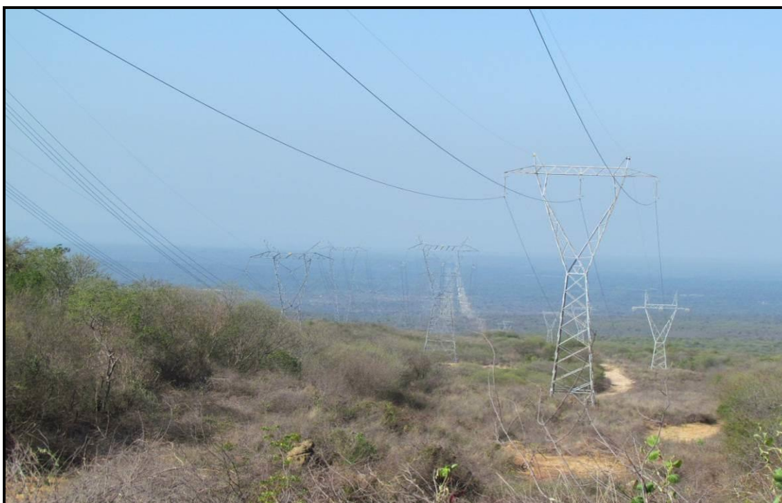
Figura 6.123. Linhas de transmissão já implantadas e em operação próximas ao PF5 - Ibiapina (CE). Foto: CARUSO JR., 2013.
