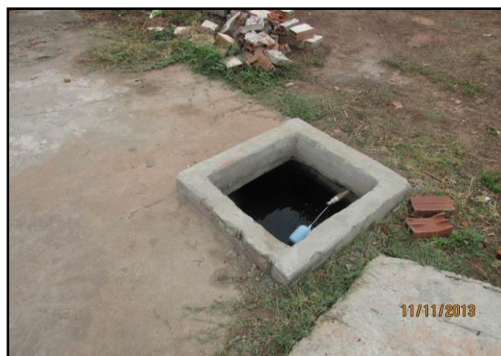
Figura 4.82. No local caixa de água de armazenagem de 20 mil litros de água.
