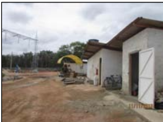
Figura 4.203. Interior canteiro JPW dentro da SE Teresina II.
