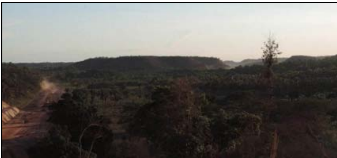
Figura 6.63. Registro fotográfico efetuado nas proximidades da obra de construção do Rodoanel de Teresina/PI (em evidência pelo maquinário operando) das formas de relevo residuais em grupamentos de mesas. Foto: CARUSO JR., 2013.
