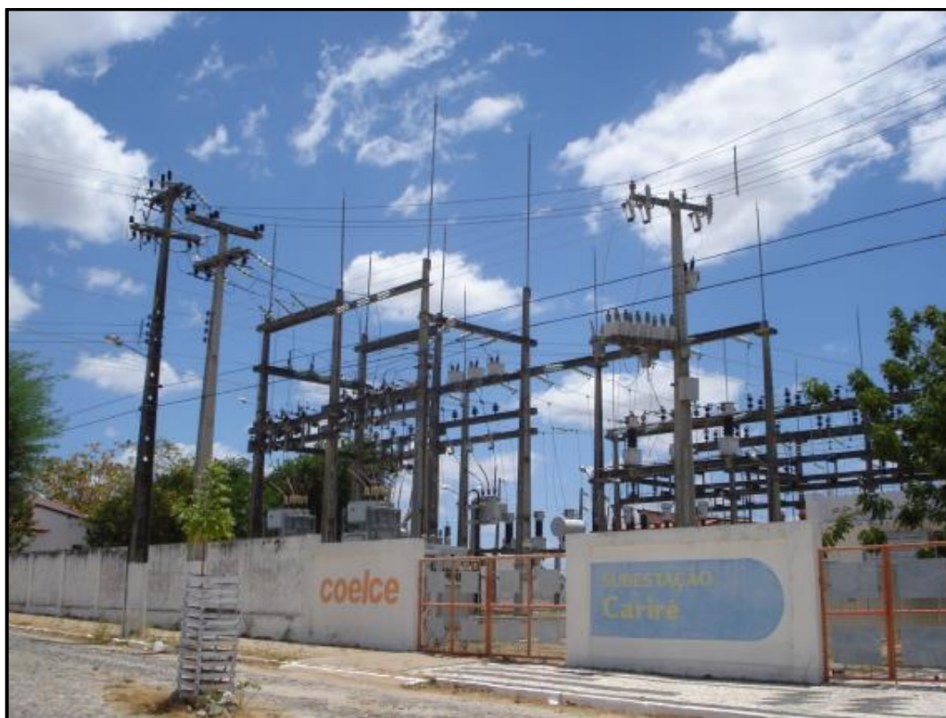
Figura 6.89. Subestação Cariré - COELCE/CE. Foto: CARUSO JR., 2013.
