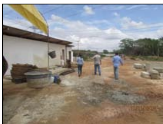
Figura 4.202. Interior canteiro JPW dentro da SE Teresina II.
