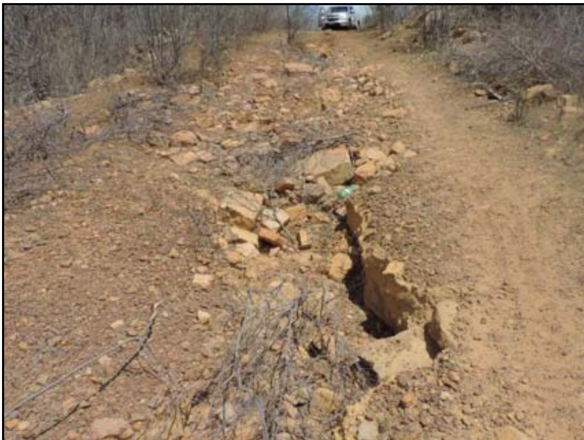
Figura 6.70. Ravinamento diagnosticado na estrada de acesso para área de influência direta (AID), nas proximidades de Ibiapina/CE. Foto: CARUSO JR., 2013.
