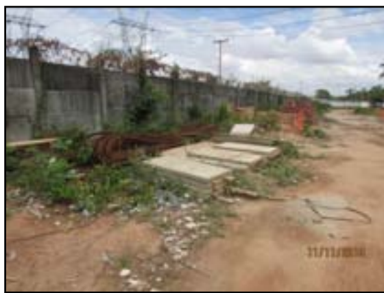
Figura 4.204. Interior canteiro JPW dentro da SE Teresina II.
