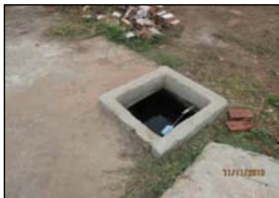
Figura 4.82. No local caixa de água de armazenagem de 20 mil litros de água.
