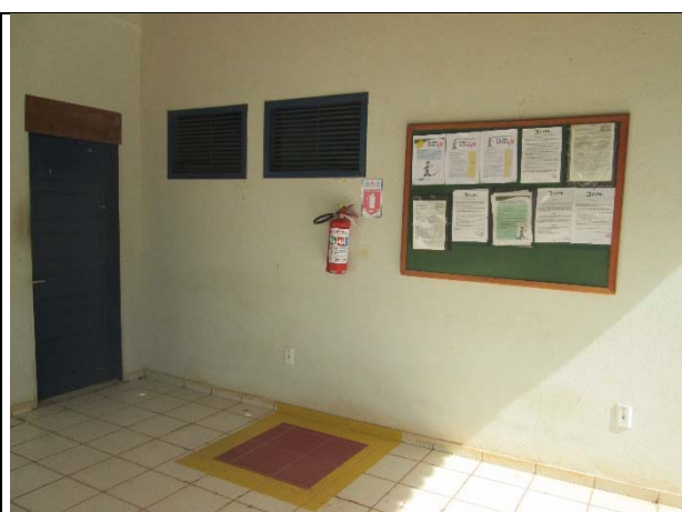
Foto 10.5.1-12 – Sinalização e armazenamento de extintores de incêndio em local de fácil acesso (outra obra).
