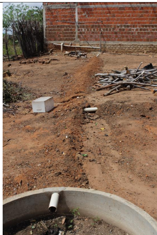
Foto 8.3.3-36 - Sistema esgotamento sanitário no PA Frei Damião.
