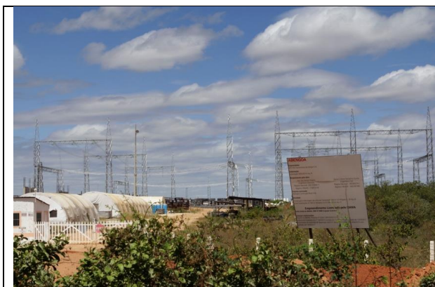
Foto 8.3.3-61 – Subestação Açú II, com as suas obras paralisadas. Município de Assú (RN).
