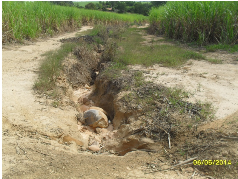
Figura 67 - Processo erosivo intenso estabelecido na estrada de serviço de um canal sob Latossolo Vermelho-Amarelo de textura média na região de Artur Nogueira, unidade de mapeamento LVA 2.
