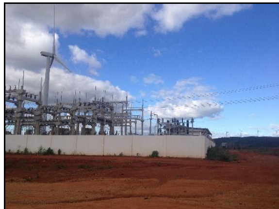
Figura 2.2.4.5-38 - Subestação e Energia Eólica - Pindaí
