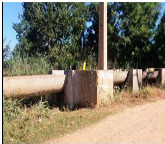
Figura 2.2.4.6-206 - Distrito de Irrigação do Perímetro Gorutuba (Nova Porteirinha-MG)
