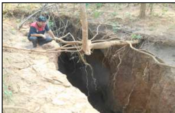
Figura 2.2.2.10-8 - Cratera formada pelo colapso de teto de dolina (cavidade) em rocha carbonática do Grupo Bambuí. Imagem da região na Comunidade de Cana Brava, Município de Montes Claros (MG). Foto: Edvaldo Ferreira/Defesa Civil (Fonte: Portal G1 – Globo em 15/05/2017 - http://g1.globo.com/mg/grande-minas/noticia/especialistas-visitam-cratera-aberta-na-zona-rural-de-montes-claros-e-analisam-riscos.ghtml )
