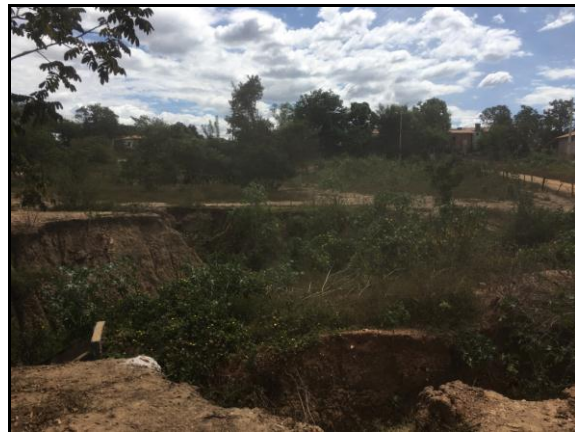
Figura 2.2.2.8-24 - Voçorocamento identificado na AE do empreendimento (UTM: 638844 / 8136189).
