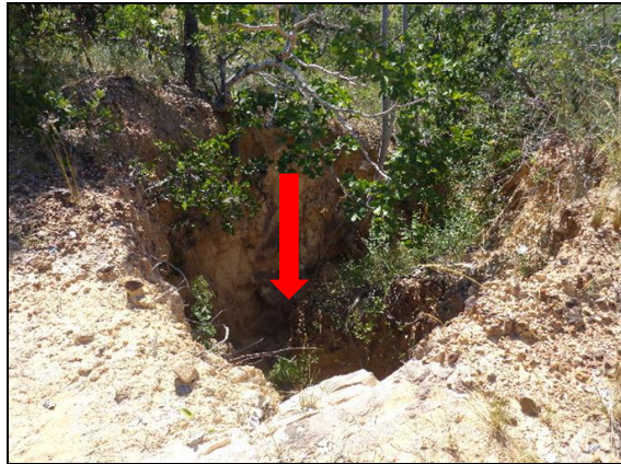
Figura 2.2.2.9-13 – (PONTO JN-118-02) Formação Três Marias (NP3tm) representado por metassiltito cinza escuro, por vezes com níveis silte-argilosos. Cavidades de dimensões métricas (aproximadamente 20 m de largura e 80 m de altura). Coordenada: SIRGAS – UTM: 0595535 / 8033798. Elevação: 769 m.
