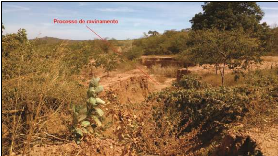
Figura 2.2.2.6-14– Processos erosivos de voçorocamento desenvolvidos em metacalcilutito da Formação Lagoa do Jacaré (Grupo Bambuí).
