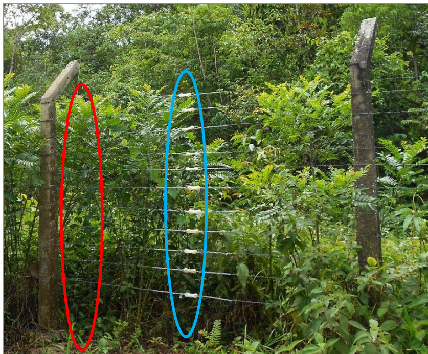
Figura 5.2.4-3 – Exemplo de cerca seccionada e aterrada. Destacam-se, na cor azul, o seccionamento da cerca, e, na cor vermelha, o aterramento.
