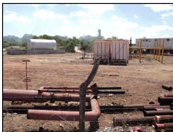
Figura 2.2.4.4.8-247 - Poço de gás da Petrobras abandonado no Assentamento Riachão Barreirinhas (MA).
