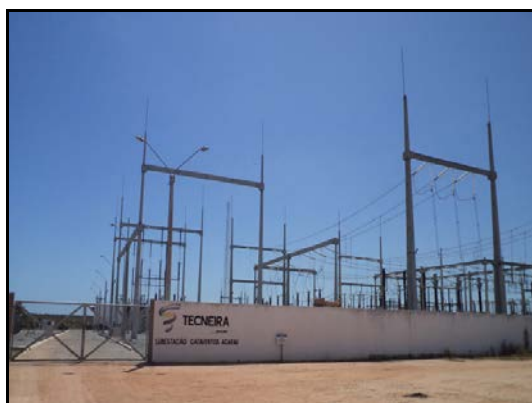
Figura 2.2.4.4.8-644 - Tecneira Grupo Procme - Subestação Cataventos Acaraú
