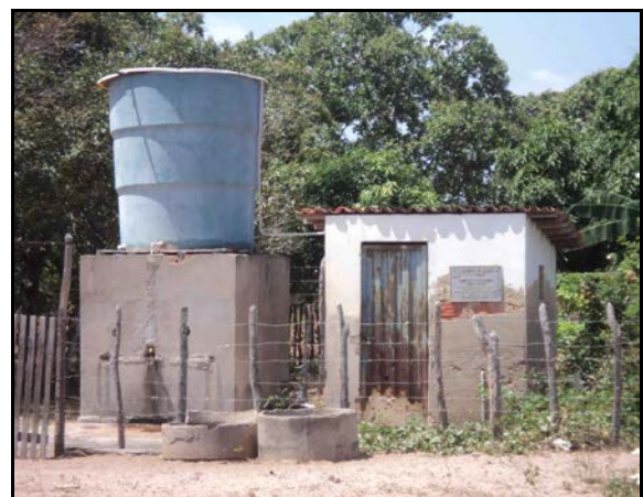
Figura 2.2.4.4.8-785 - Poço central com bomba Lagoa das Pedras - Luís Correia (PI)
