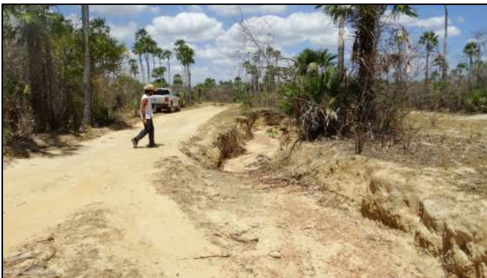
Figura 2.2.2.9-67 - Erosão no solo causada por canais temporários.
