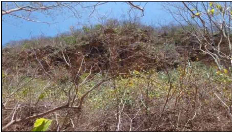
Figura 2.2.2.9-34 - Topo do morro aflorando arenito levemente fraturado com pequenas fendas centimétricas formadas por ação meteórica.
