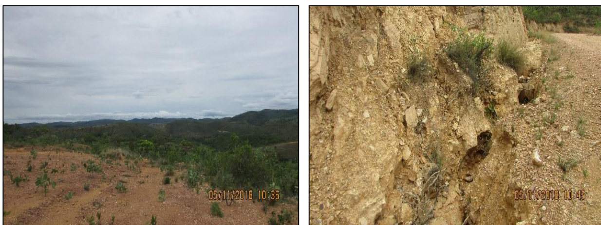
Figura 87 - Processo erosivo na ADA da LT UTM 23K, 626.984E/7.876.998N
