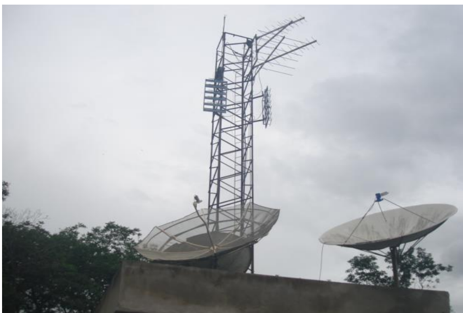
Figura 190 - Torre de telefonia móvel e Antena de televisão no município de Tumiritinga
