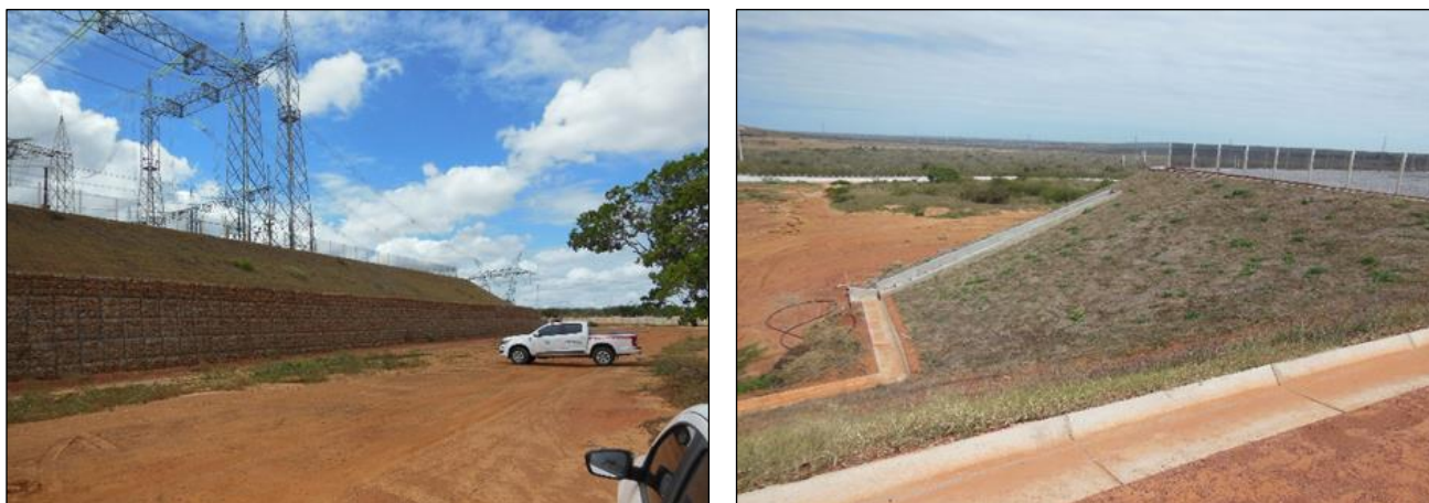
Figura 6. Taludes com vegetação adequada e dispositivos de drenagem permanentes: exemplos de medidas de controle de processos erosivos.
