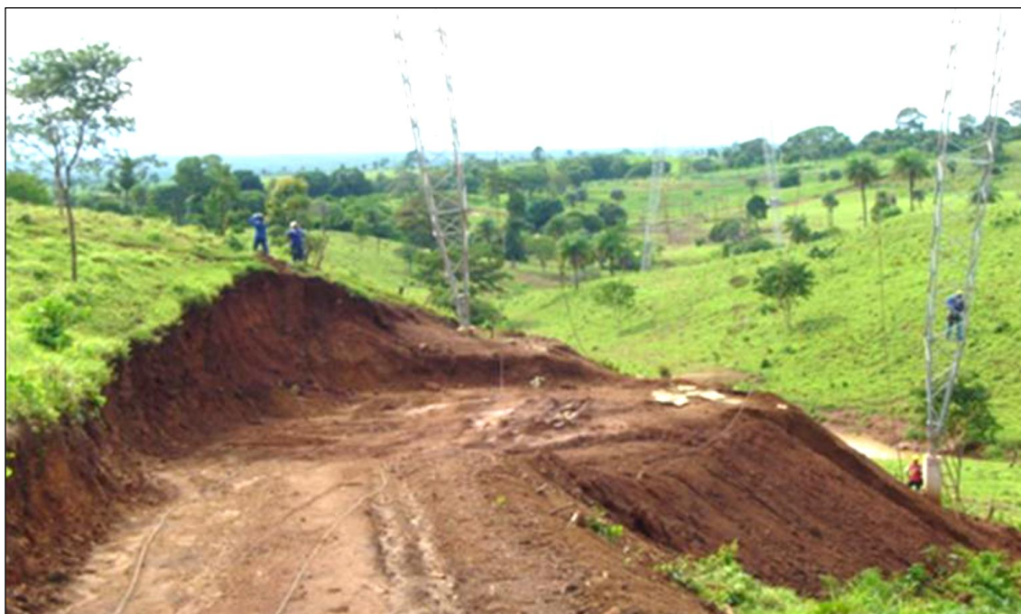
Figura 3. Trabalhadores preparando as áreas de corte (talude) e de aterro junto à área de base de torre para receberem dispositivos temporários de prevenção e controle de erosão (banqueteamento) e revegetação posterior, no âmbito do PRADA (outra LT).
