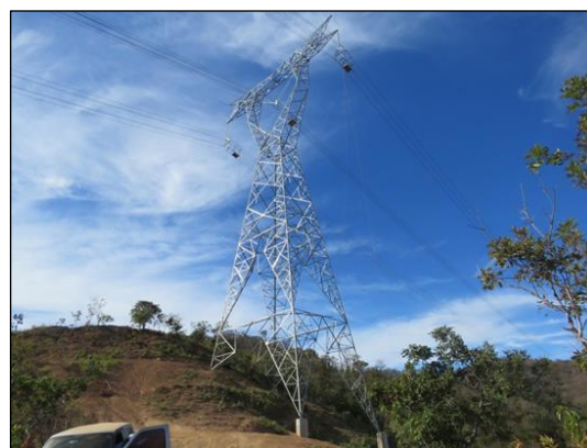
Figura 8. Exemplo de torre autoportante locada em área íngreme com bases diferenciadas para nivelamento.
