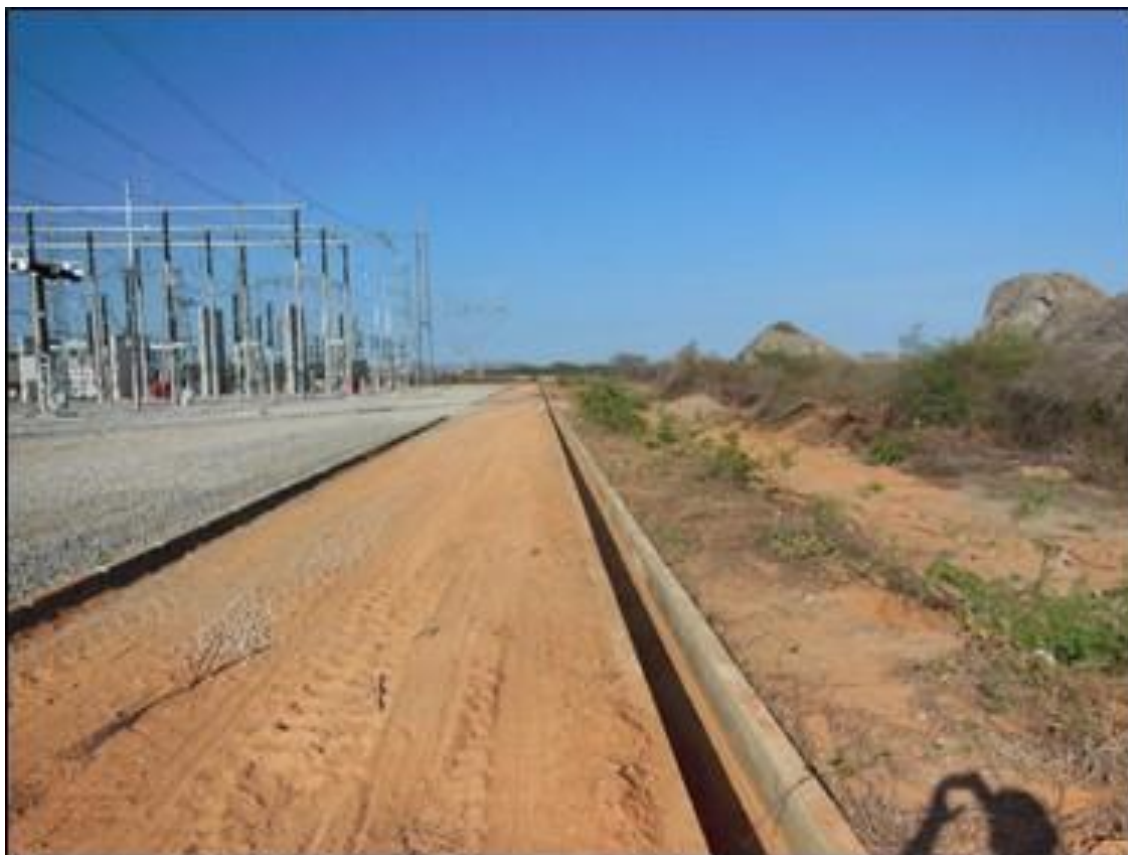
Figura 2. Dispositivo permanente de drenagem instalado para proteger a SE.
