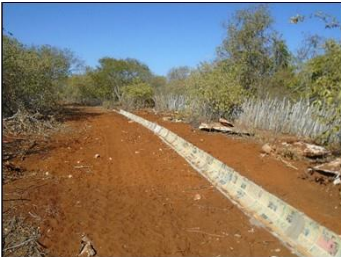
Figura 1. Dispositivo permanente de drenagem (canaleta) para evitar erosão na área prevista para o acesso.
