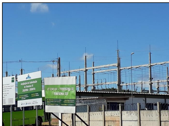
Figura 2.2.4.13-198 - Subestação Teresina III
