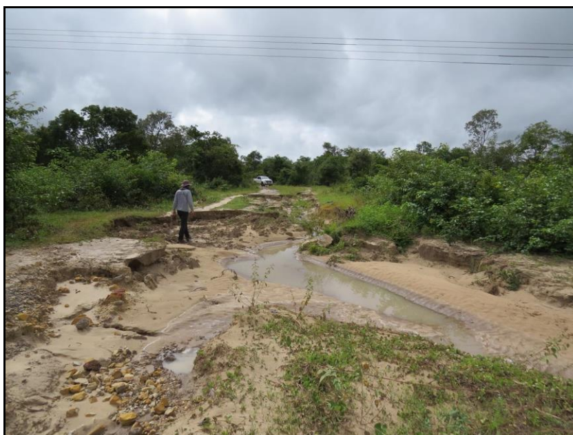
Figura 2.2.2.8-7 - Erosão em estrada vicinal no ponto 17, provocada por tráfego de veículos e agravada após intensa pluviosidade. Coordenadas: 24 m X 170053 - Y 9498316.
