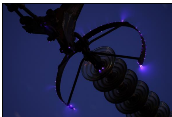
Figura 2.2.2.2-1 - Efeito Corona, ionizando o ar em torno dos condutores de uma LT de 500 kV
