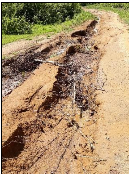
Figura 2.2.4.13-43 - Condições precárias de acesso à residência isolada
