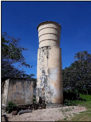
Figura 2.2.4.13-40 - Caixa d'água comunidade Santa Luzia.
