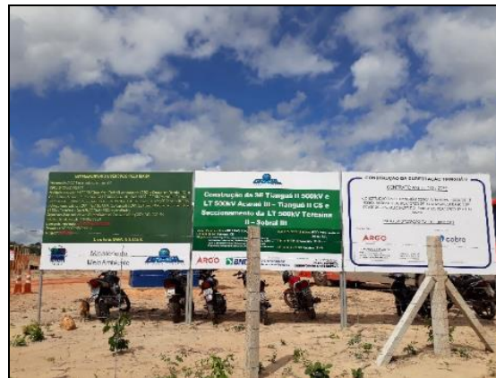
Figura 2.2.4.13-82 - Placa de Sinalização da SE Tianguá II
