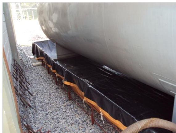
Detalhe da bacia de contenção.
