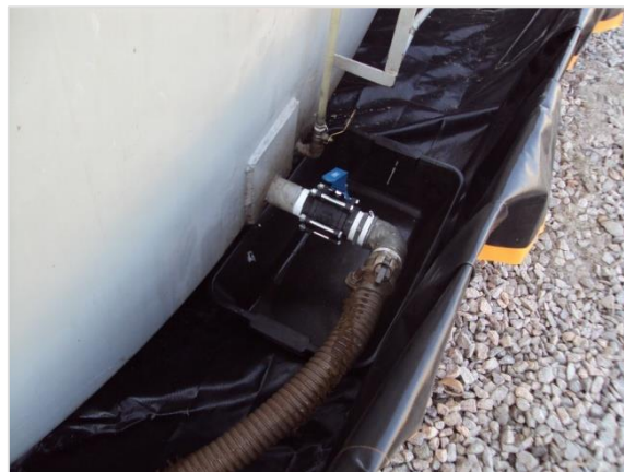
Bandejas de captação junto às conexões de saída de óleo.
