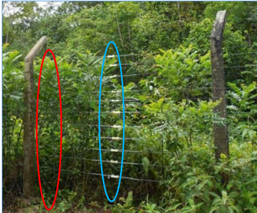
Figura 1.4-28 – Exemplo de cerca seccionada e aterrada. Destacam-se, na cor azul, o seccionamento da cerca, e, na cor vermelha, o aterramento.
