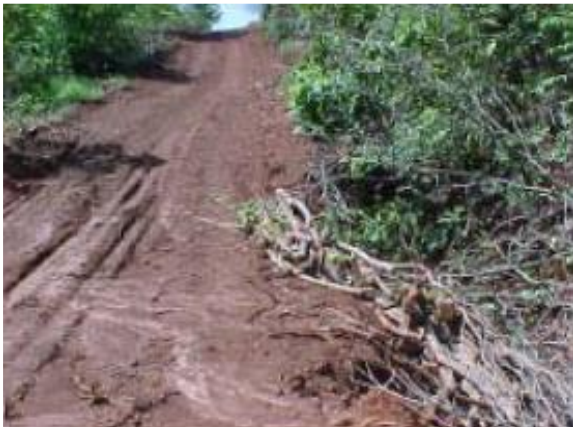
Foto I-9 – Necessidade de colocar contenções laterais no corte executado para construir acesso.
