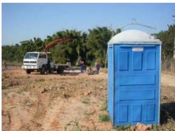
Foto I-7 – Banheiro químico localizado na praça de serviço, no canteiro de obras.
