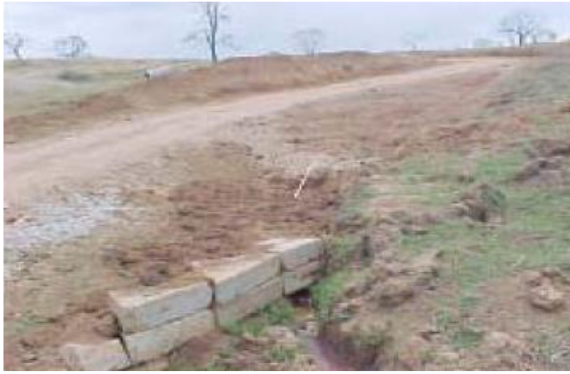
Foto I-11 – Dispositivos de contenção de acessos.
