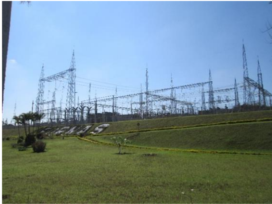
Foto 5.4.2-1: Vista da SE de Itutinga, em Itutinga-MG.
