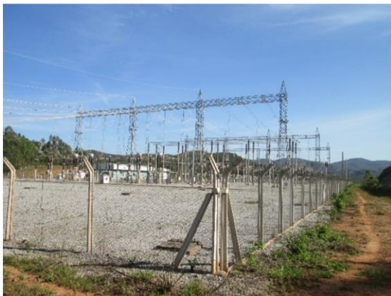
Foto 5.4.2-79: Local de chegada da LT, na SE Barro Branco, na área rural de Mariana-MG.
