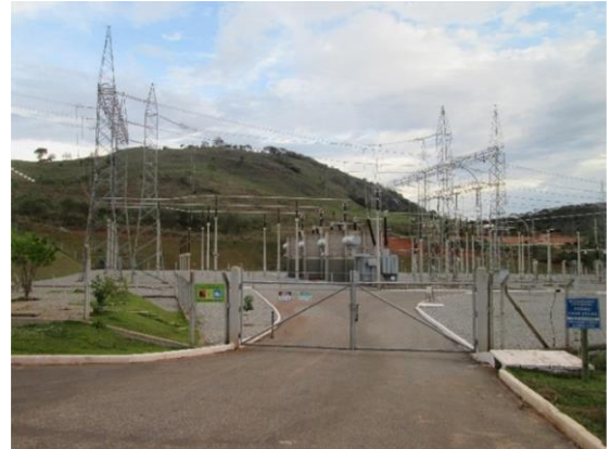
Foto 5.4.2-68: Entrada da SE Itabirito II, em Ouro Preto-MG.
