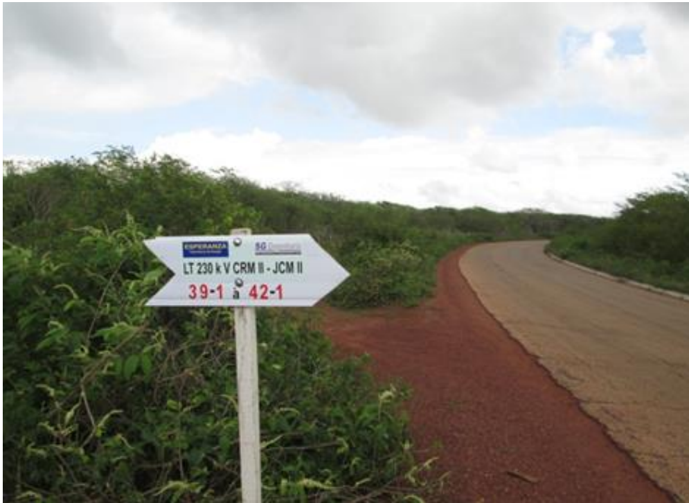
Figura 1.4-25 – Exemplo de placa de sinalização de LT existente, indicando a numeração das torres.
