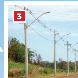
REDE DE DISTRIBUIÇÃO
