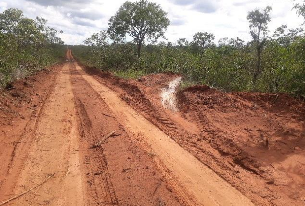
Figura 8.5.1-7 – Instalação de saída d'água para drenagem da via, direcionando a água superficial para área vegetada na lateral do acesso (outra obra).
