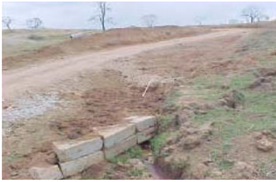
Figura 8.5.1-9 – Dispositivos de contenção de sedimentos em acesso (outra obra).
