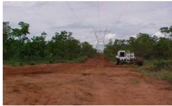
Figura 8.5.1-10 – Dispositivos de contenção de sedimentos em acesso (outra obra).
