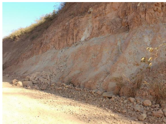
Foto 5.2.8-17: Talude na estrada entre Lelivéldia e Virgem da Lapa, demonstrando o caráter friável do material, nos desmoronamentos. Coord.: 23 K 771968.24 m E 8143773.09 m S.
