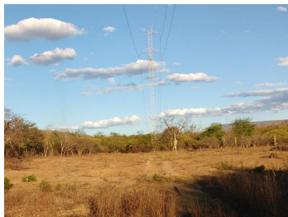
Foto 6.2-3: Estruturas de uma LT já existente na área de influência do empreendimento. Coord.: 23 K 814544.72 m E 8138406.63 m S. Fonte: Acervo Lapiá, 2016.
