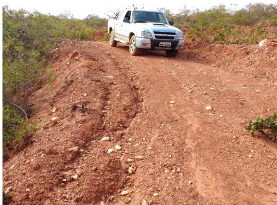
Foto 5.2.8-28: Aspecto da Cobertura, exposta em estrada trecho Irapé-Janaúba 3, com sulcos erosivos . Coord.: 23 K 745303.76 m E 8194582.63 m S
