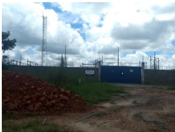
Foto 6-16: Trecho Estrada do Café. SE Coelba na estrada do Café, à aproximadamente 2 km do traçado da LT. Localização: -11.811579, -45.724348.
