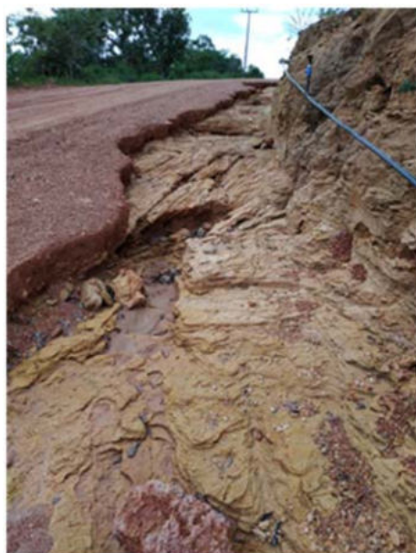
Foto 6.1-11: Processo de ravinamento avançado à beira do talude de corte de estrada em arenito coberto por folhelho. Lat 11° 53'18.38"S / Long 45° 35'22.63"O
