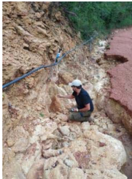
Foto 6.1-12: Processo de ravinamento avançado à beira do talude de corte de estrada em arenito coberto por folhelho. Lat 11° 53'18.38"S / Long 45° 35'22.63"O
