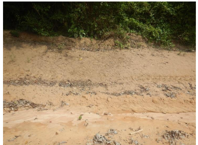
Sedimento areoso e linha de cascalho no Ponto 3.
