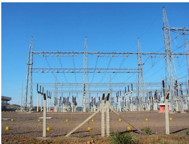
Foto 1.4-1 Bay da SE Foz Chapecó para a LT 230 kV Foz Chapecó – Pinhalzinho C1
