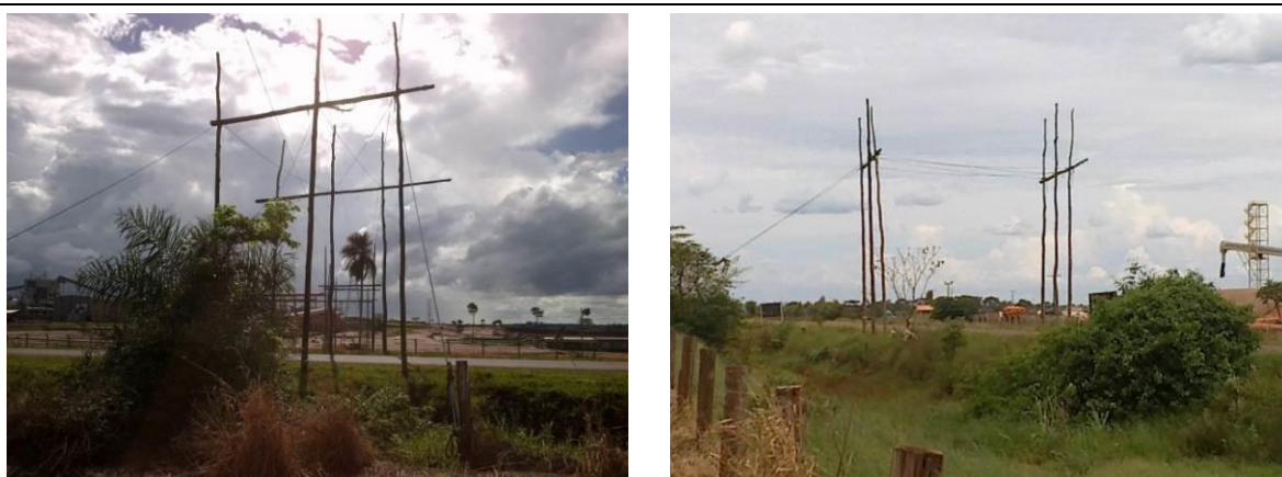
Figura 2.2-4 Empacadura utilizada nos lançamentos de cabos, para evitar o contato dos condutores com o solo, protegendo os carregadores e permitindo a passagem de veículos.
