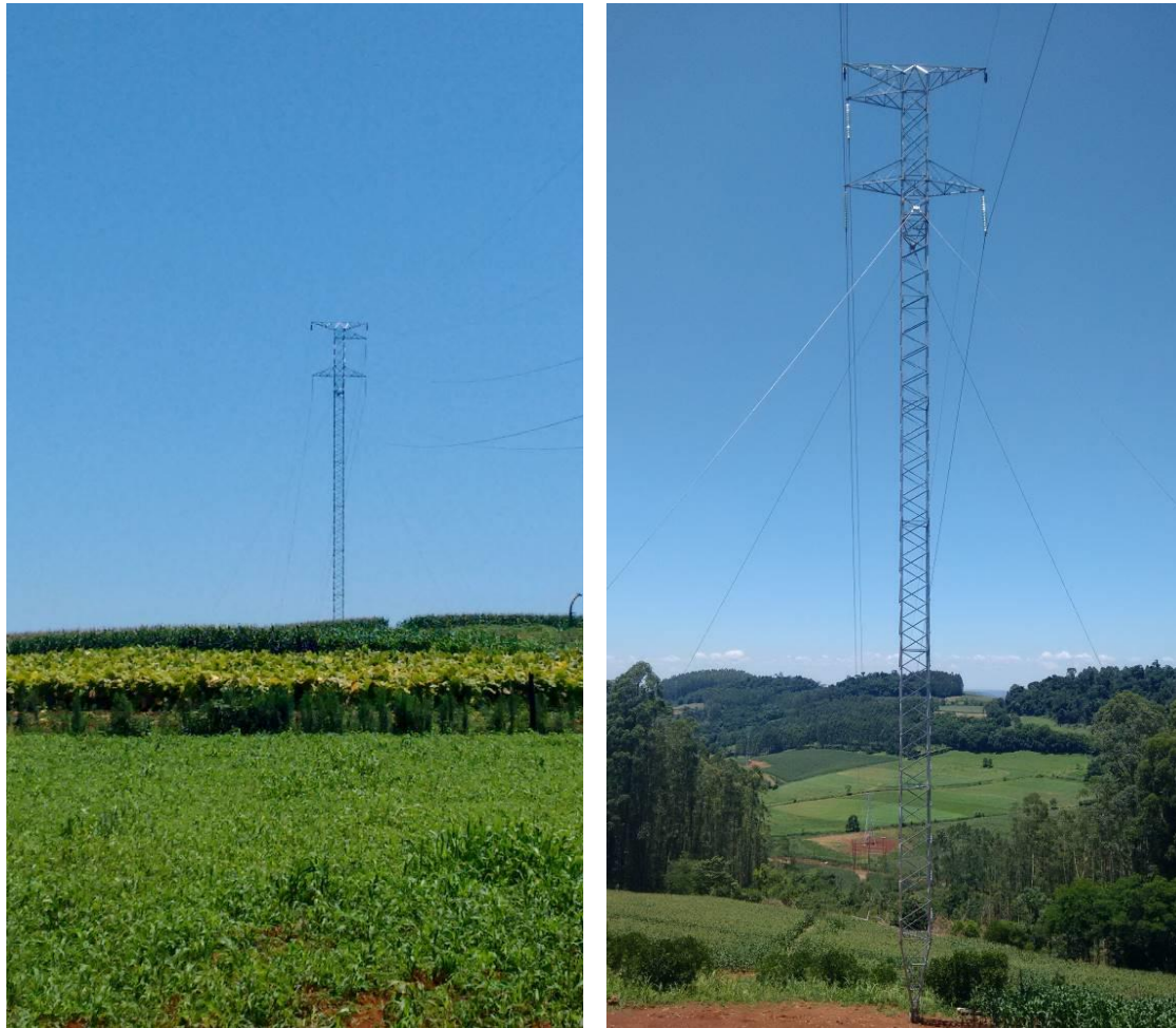
Figura 5: Modelo de Torre Estaiada. Fonte: "LT 230 kV Foz do Chapecó – Pinhalzinho 2 (C1)".
