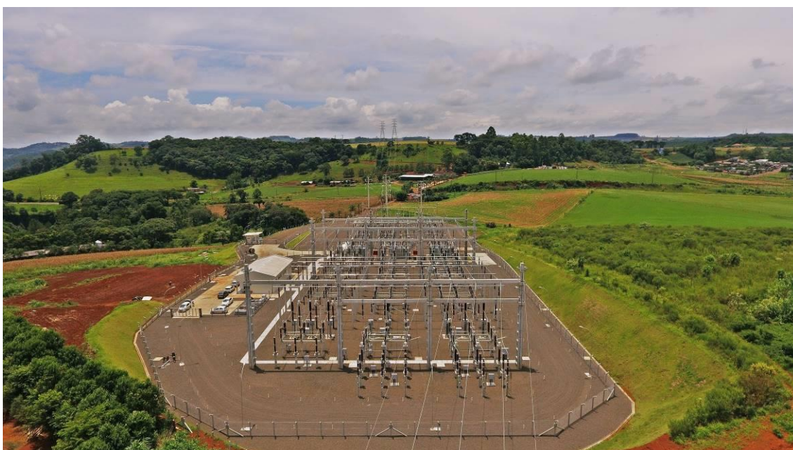
Figura 7: Subestação Pinhalzinho 2 - Final da “LT 230 kV Foz Chapecó – Pinhalzinho 2 (C2)”.
