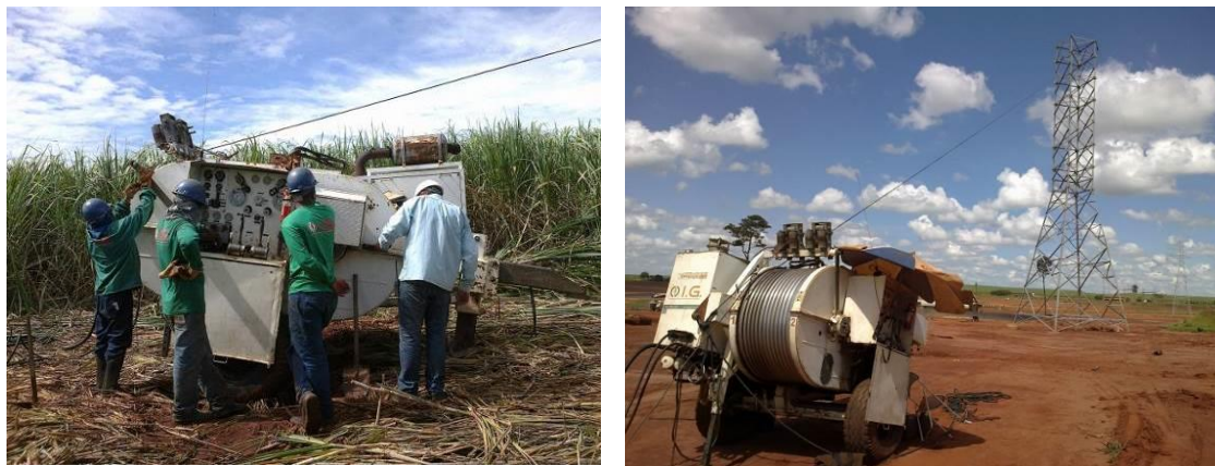
Figura 8: Lançamento de cabo condutor utilizando o sistema Puller/Freio. Com este tipo de equipamento o cabo condutor é lançado tensionado.
