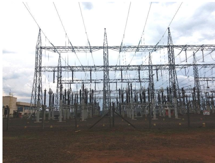
Figura 2: Início da “LT 230 kV Foz Chapecó – Pinhalzinho 2 (Circuito 2)” na Subestação Foz do Chapecó.
