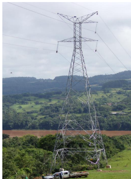
Figura 6: Modelo de Torre Autoportante (Fonte: "LT 230 kV Foz do Chapecó – Pinhalzinho 2 (C1)").
