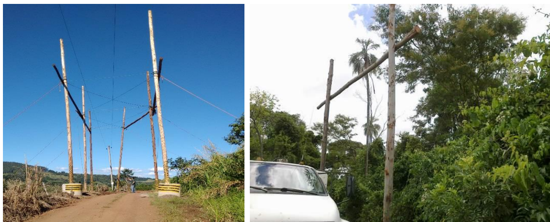
Figura 12: Empacadura utilizada nos lançamentos de cabos, para evitar o contato com a vegetação a ser transposta pela linha de transmissão.
