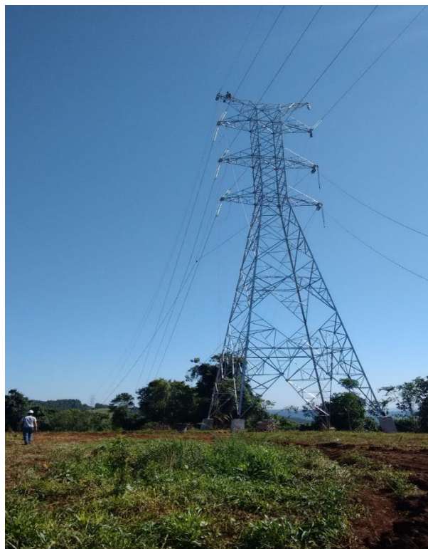
Figura 3: Torre Autoportante do Circuito Duplo (“LT 230 kV Foz do Chapecó – Pinhalzinho 2 (C1) – LT Existente”).
