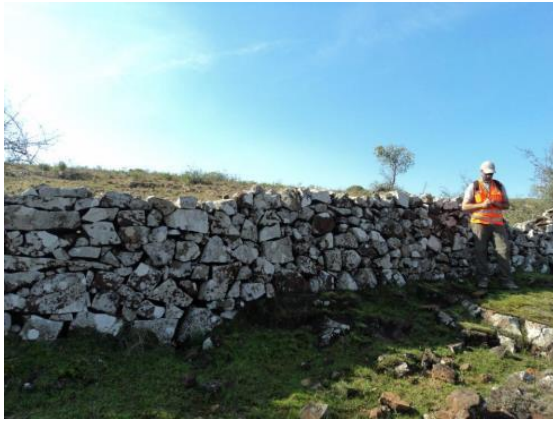
Figura 98. Muro de taipa encontrado na AE da LT 230 kV CGE Fronteira Sul – SE Livramento 03 (CELTES, 2018).
