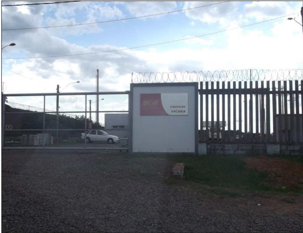
Figura 3 - Vista da Subestação. Coordenadas E 508393 N 6848905.
