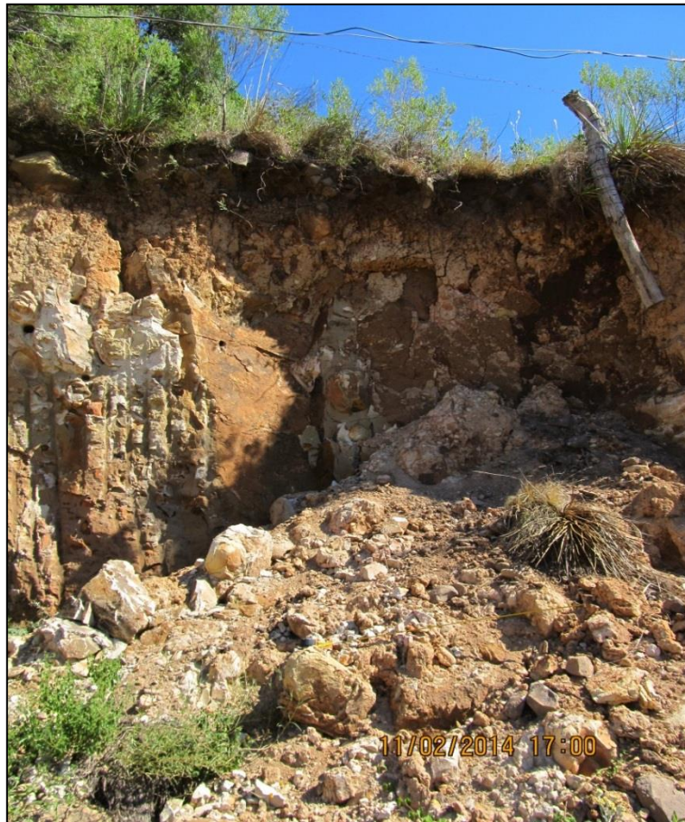
Figura 47 - Evidência de tombamento em corte de estrada na AID.
