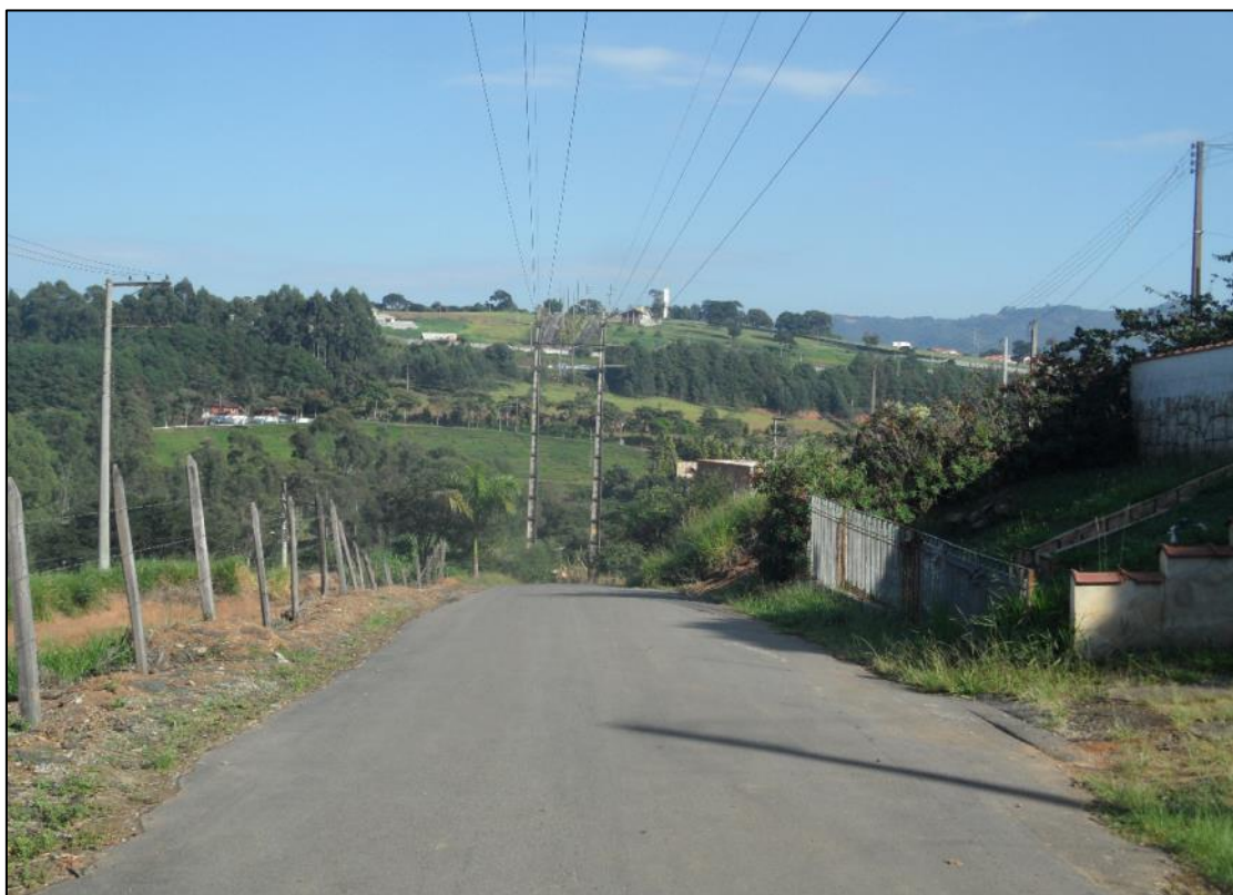
Foto 63 – Saída da SE Extrema.
