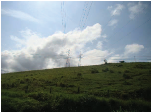
Figura 134 - Vista parcial do traçado da LT, próximo da torre 89.
