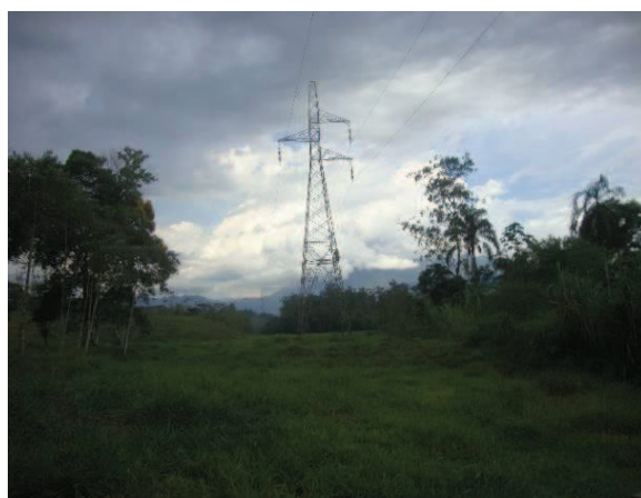
Figura 125 - Vista parcial do traçado da LT, próximo da torre 98.
