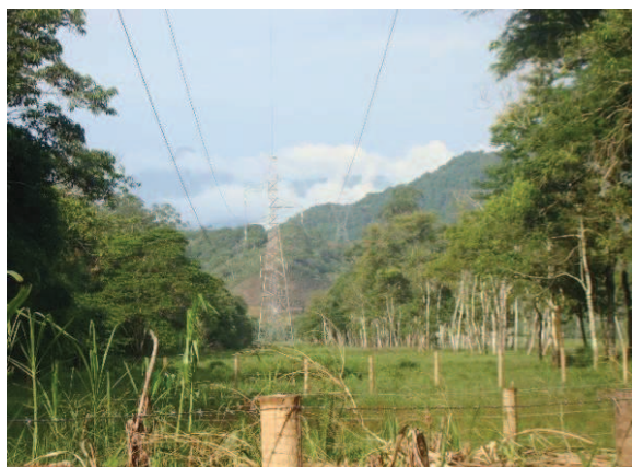
Figura 121 - Vista parcial do traçado da LT, com vista para a torre 95.
