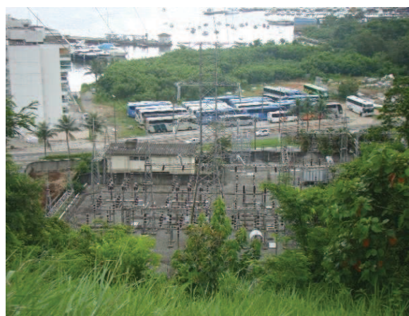
Figura 93 – Subestação da Enel, localizada no Centro de Angra dos Reis.
