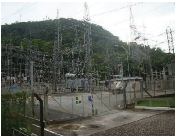
Figura 97 - Subestação Angra, localizada próximo da Usina Nuclear.
