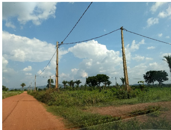
Figura 106: Infraestrutura de iluminação pública no setor de chácaras
