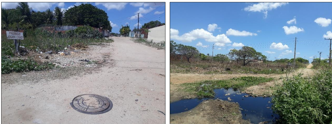
Figura 78: Tampa de bueiro e esgoto a céu aberto na Rua Cabo João.
