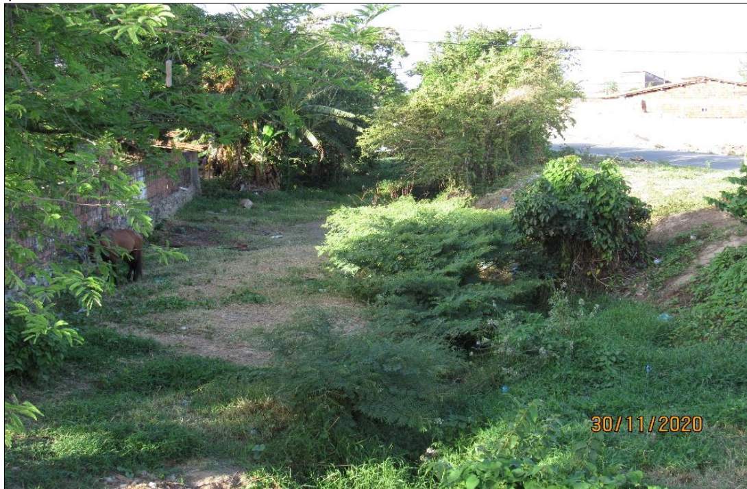
Figura 97: Drenagem dividindo espaço com esgoto a céu aberto em um dos cursos d'água que cortam a CE-350.
