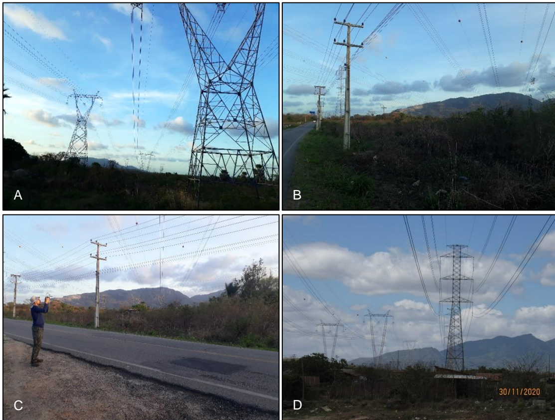
Fonte: HL Soluções Ambientais, 2020. Legenda: A) LTs de 500kV; B) Linha de Distribuição de 13 kV; C) LT 500kV e LD 13,5 kV; D) Torre autoportante de LT de 230kV.
