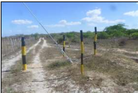
Sinalizadores de estais
